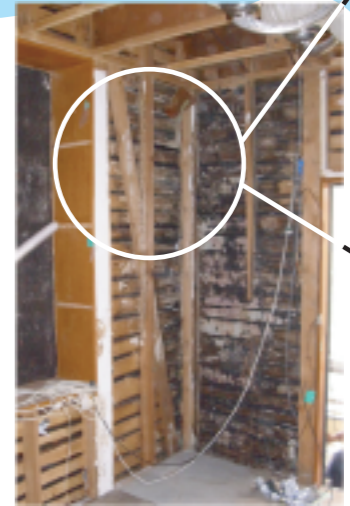
解体後:めくってみてビックリ!! 白蟻被害は無いものの それよりも恐ろしい現象が...
