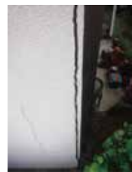
↑外壁クラック
