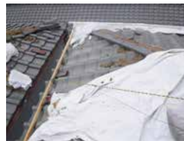
↑屋根シート破れる
